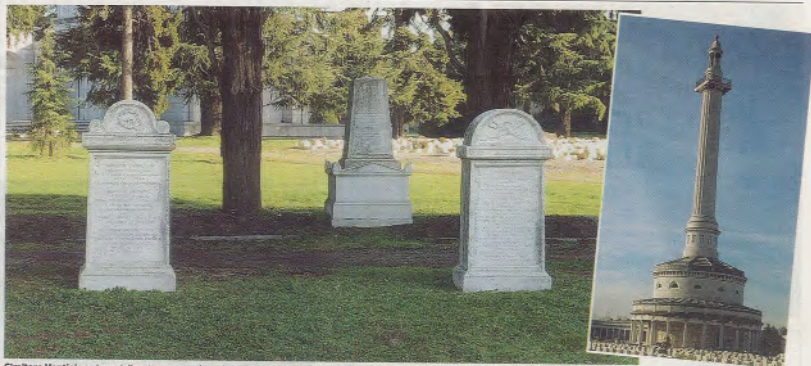
Cimitero Vantiniano Lavori di restauro per salvare i monumenti e le tombe rovinate dal tempo e da pioggia e smog
